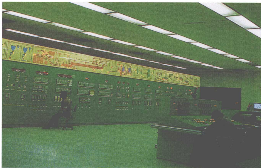
江西水泥厂中央控制室
