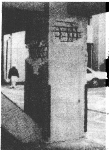
图 1-15 HA 公寓 1 层 带斜撑的框支柱震害
