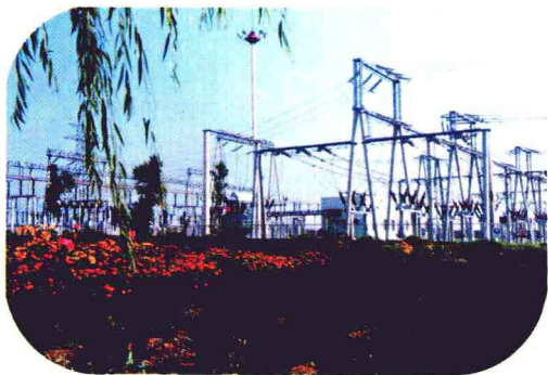
现代化的龙城一次变电所
