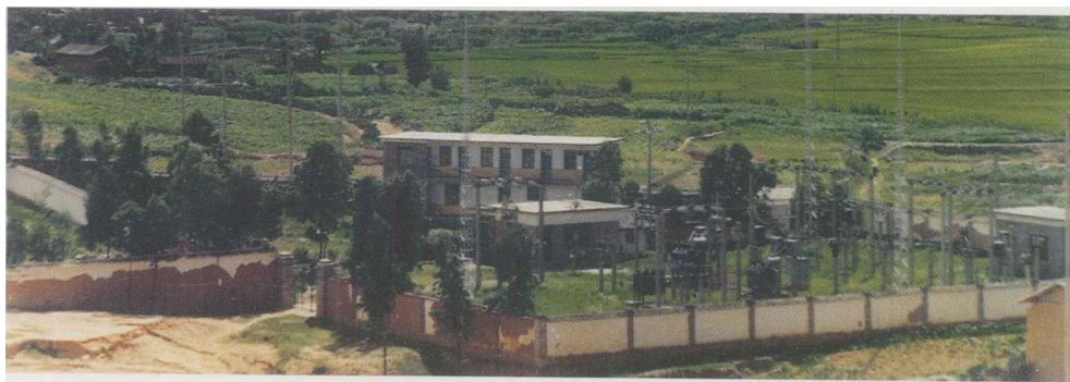
► 总府庄变电站
