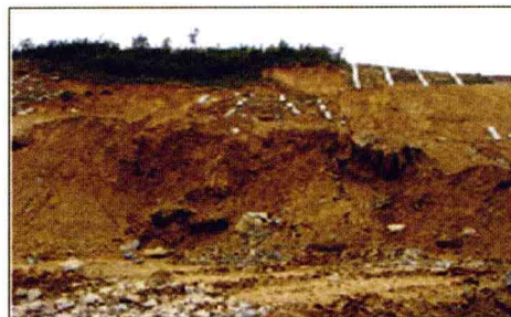
土质坍塌 (湖南永州, 永蓝高速, 2010年4月29日)
