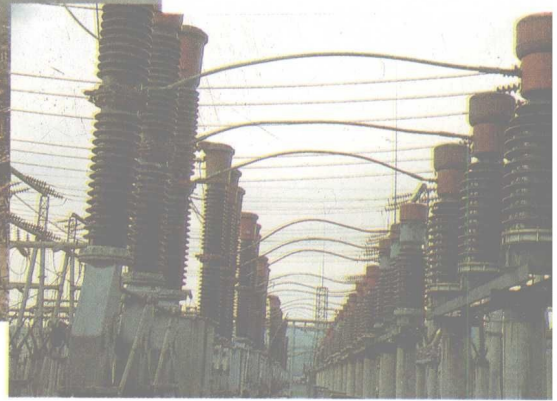
同兴110万KW变电站
