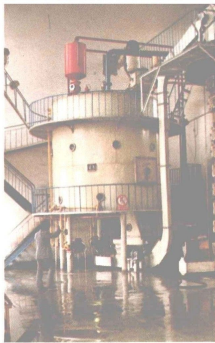
县植物油厂的浸油车间
