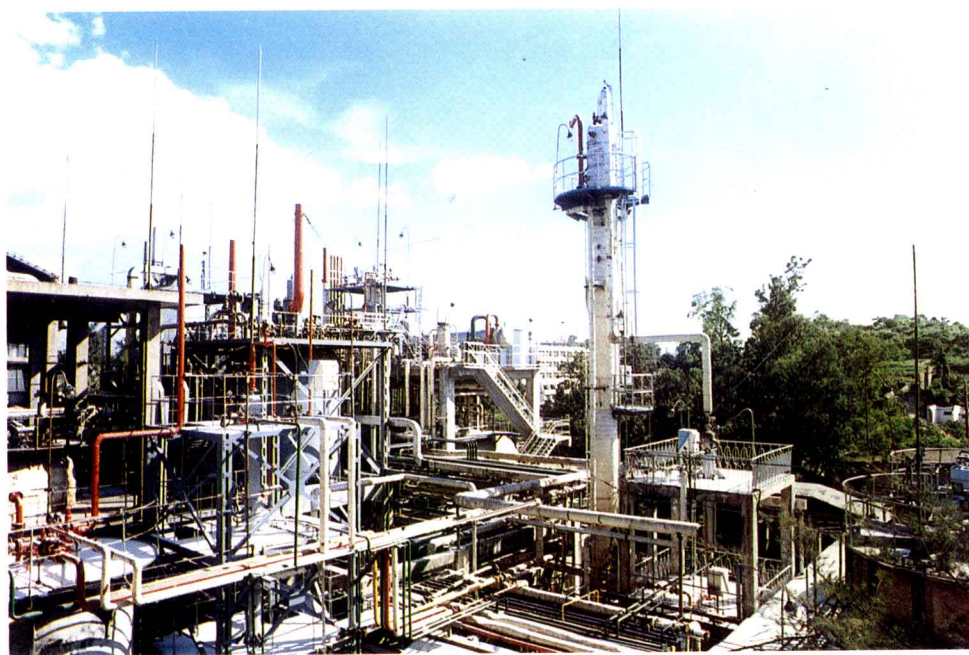
福州第二化工厂聚氯乙烯车间一角
