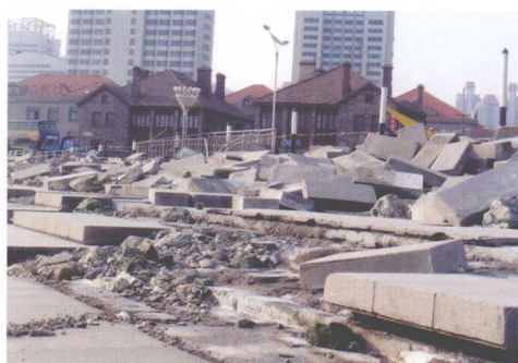
“0303”特大温带风暴潮灾害，山东烟台市国际会展中心灾害现场
