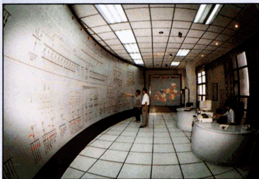
电力调度中心
