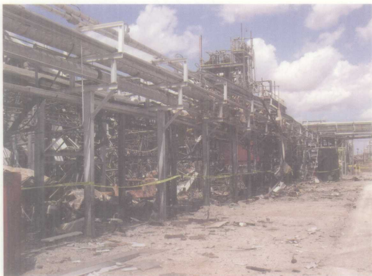
2004年4月23日台塑美國伊利諾州工廠爆炸，有4名工人喪生、8人受傷，75%的廠房毀於一旦。美國化學品安全委員會(Cheical Safety Board, CSB)認為：「這起意外顯示，台塑管理人並不嚴肅看待這些潛在危險。」
