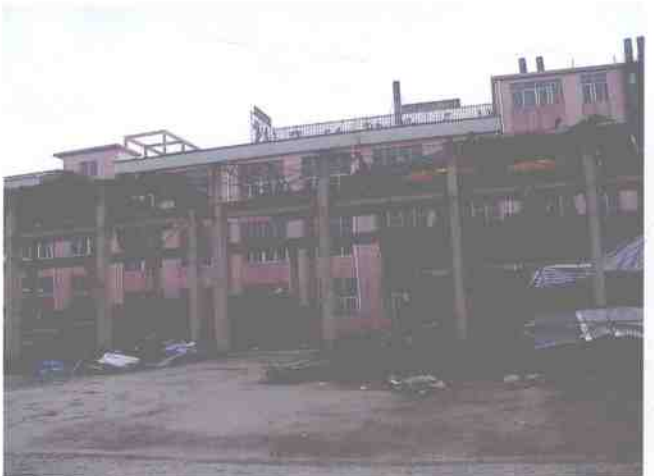
顺德区一损毁厂房。
