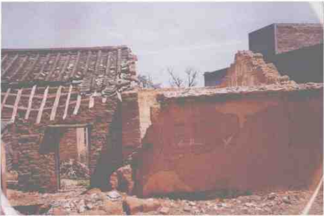
电白县龙山镇部分民房倒塌。
