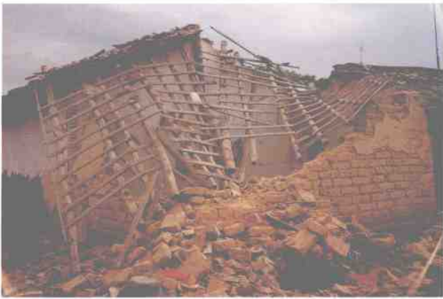
电白县爵山镇部分民房倒塌。
