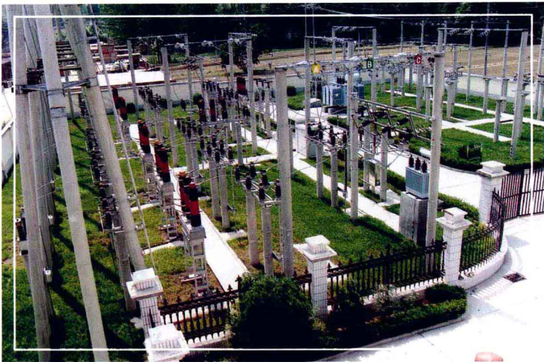
磨沟口中心变电站一角
