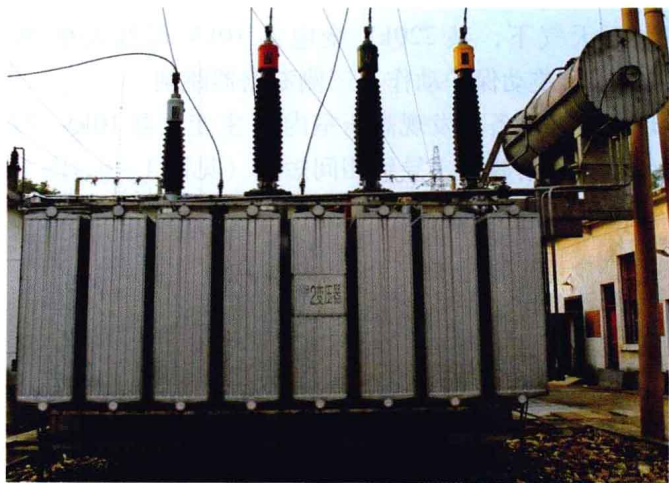
图 1-5 #2 主变压器高压侧接线相序排列错误
