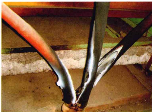
图 1-2 #1 主变压器 35kV 侧进线电缆终端短路情况
