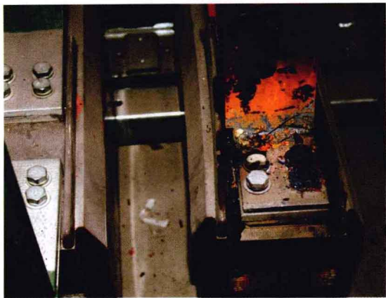
图 1-3 #1 主变压器 10kV 侧 C 相 TA 损坏情况
