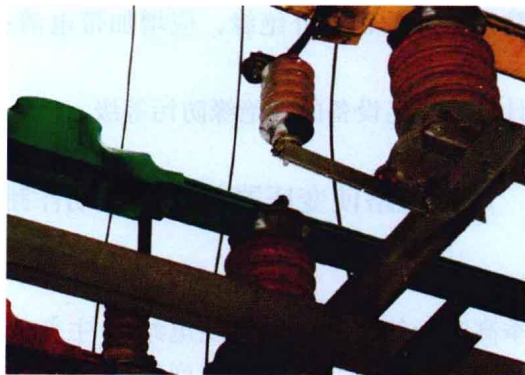
图 1-1 #1 主变压器 10kV 侧 A 相避雷器外绝缘闪络情况
