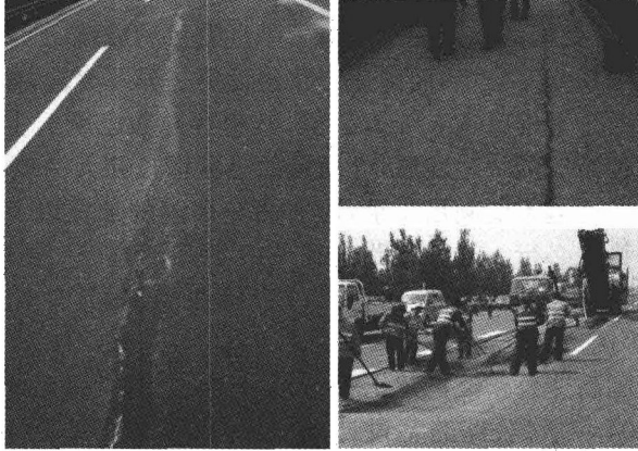
图 1-1 道路纵向裂缝
