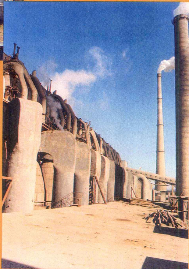
辽宁发电厂麻石水膜除尘装置
