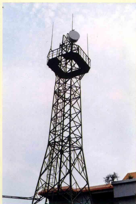
中国移动通信集团广东有限公司南海分公司九江基站
