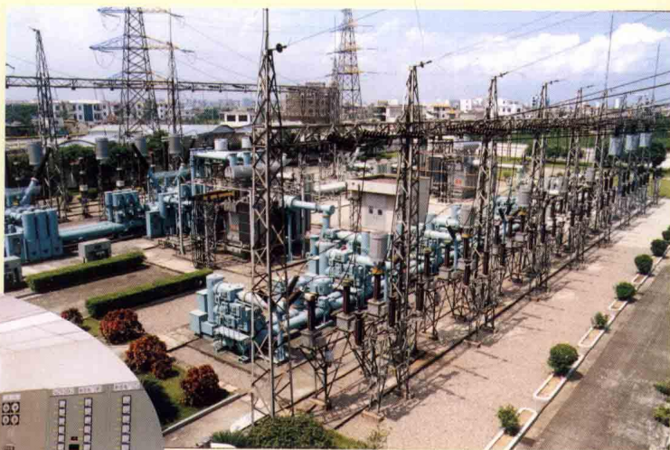
位于下北村内，1987年9月22日 开始运行的南海220千伏变电站。
