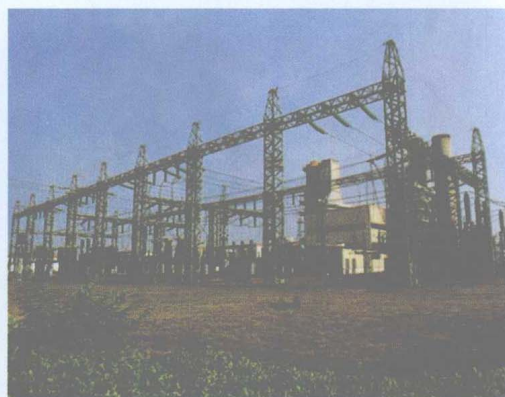
斗门大型变电站
