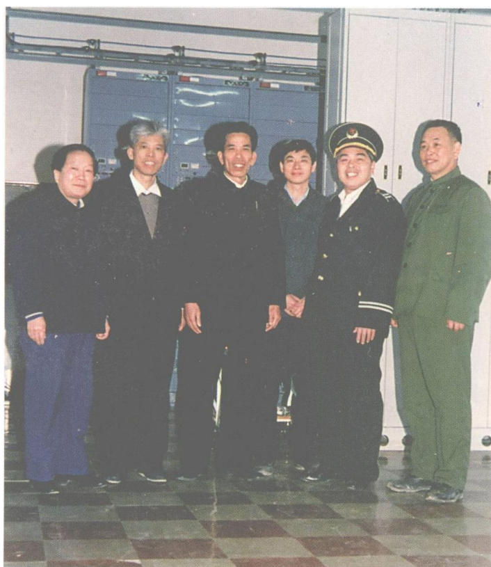
▲1987年3月钦州地委书记李素芬(左三)检查电信机房。
