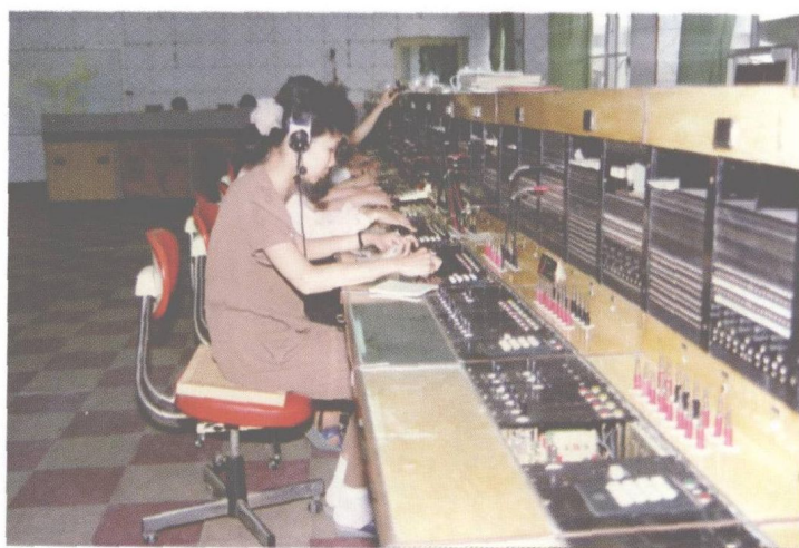
▲磁石交换机房。
