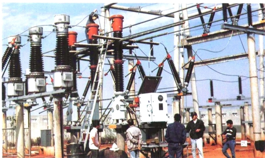
县城 110 千伏输 变电站一角
