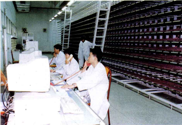
30年代的F-150程控交换机测量室（位于电信枢纽大楼）。
