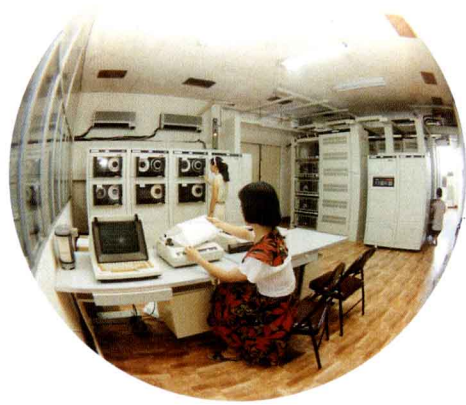
1983年开通的F-150长途程控交换机房。
