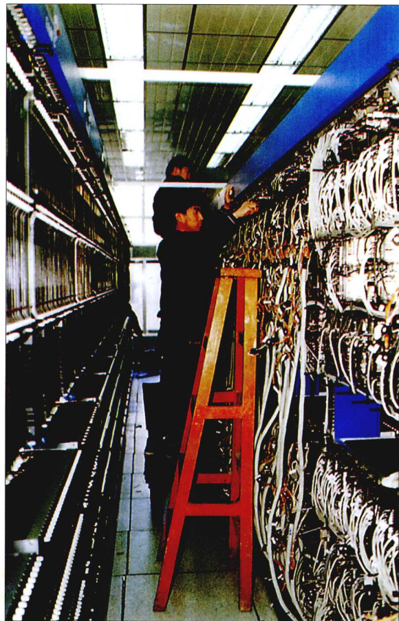
银行贷款支持的贵阳电信局程控电话交换机
