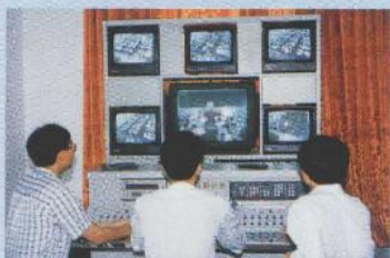
学校闭路电视教学监控系统，可监控 37 个教学班教学情况
