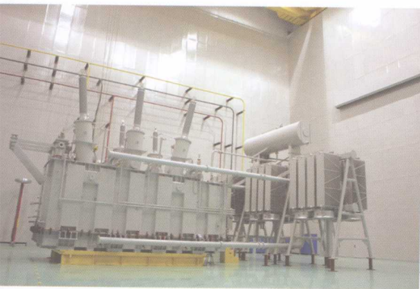
出口加拿大400MV·A/230kV自耦变压器
