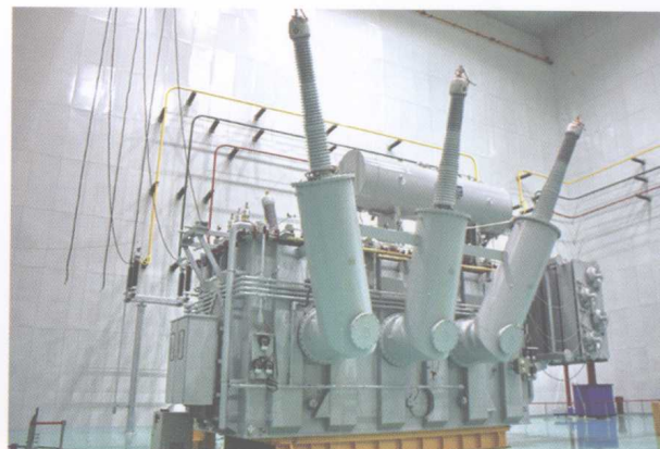
出口美国280MV·A/345kV电力变压器
