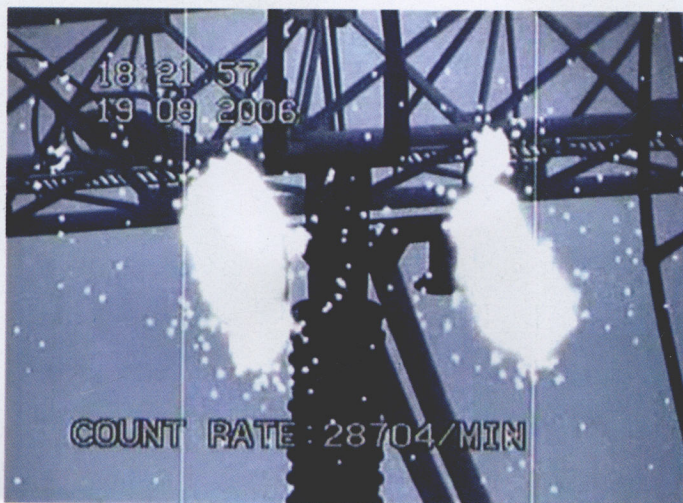
图 1-17 接地开关均压环尺寸过小紫外放电图谱（一）
