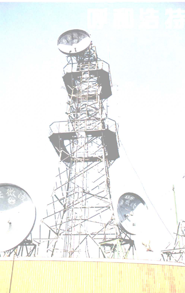
遍布呼市地区无线基站铁塔中的一个
