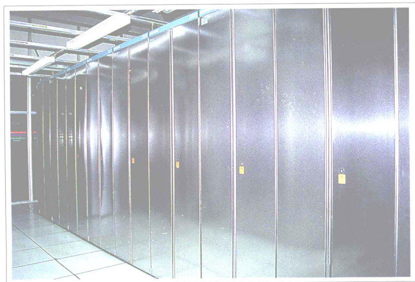
整洁宽敞的移动交换机房和规模庞大的交换设备
