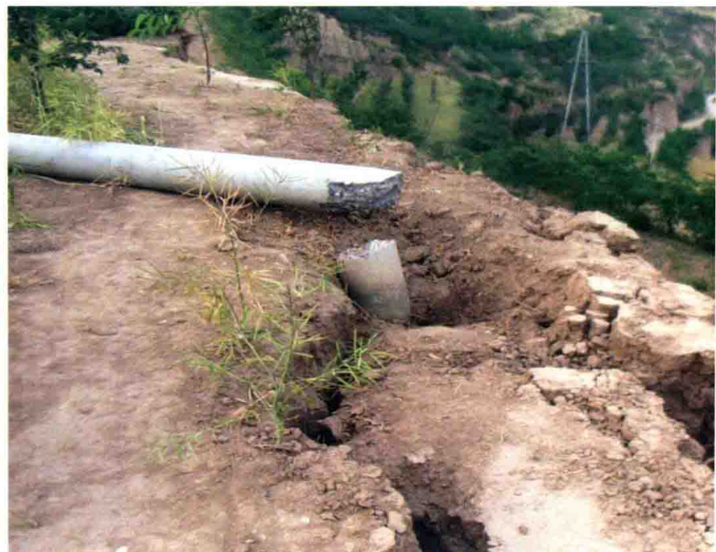
电力设施受损图
