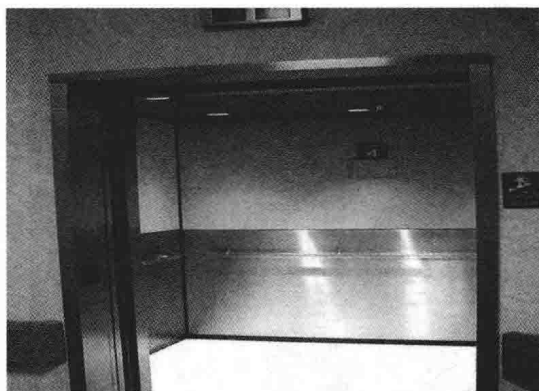
图 1-14 Elevator / Lift 垂直电梯
