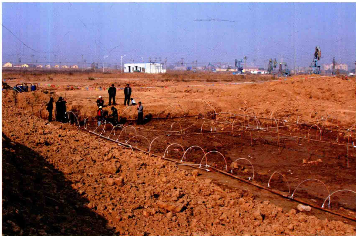
图七 海北遗址发掘区降水设施
