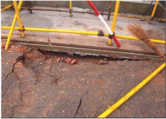
图 2-13 回填土未按规范要求施工导致地基沉降
