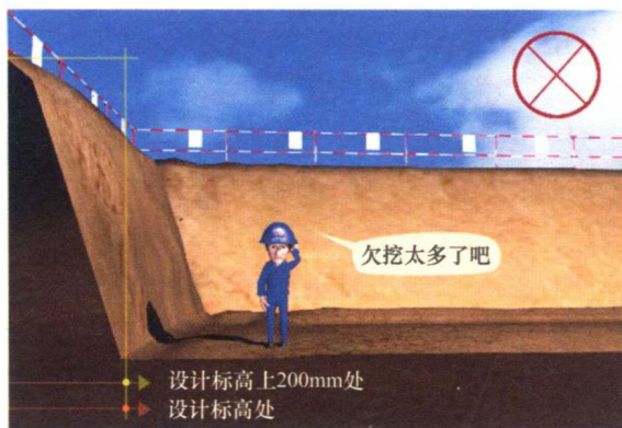
图 2-2 地基未按设计标高开挖导致欠挖
