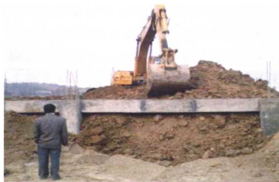
图 2-11 灰土拌合不均匀, 虚铺厚度过大
