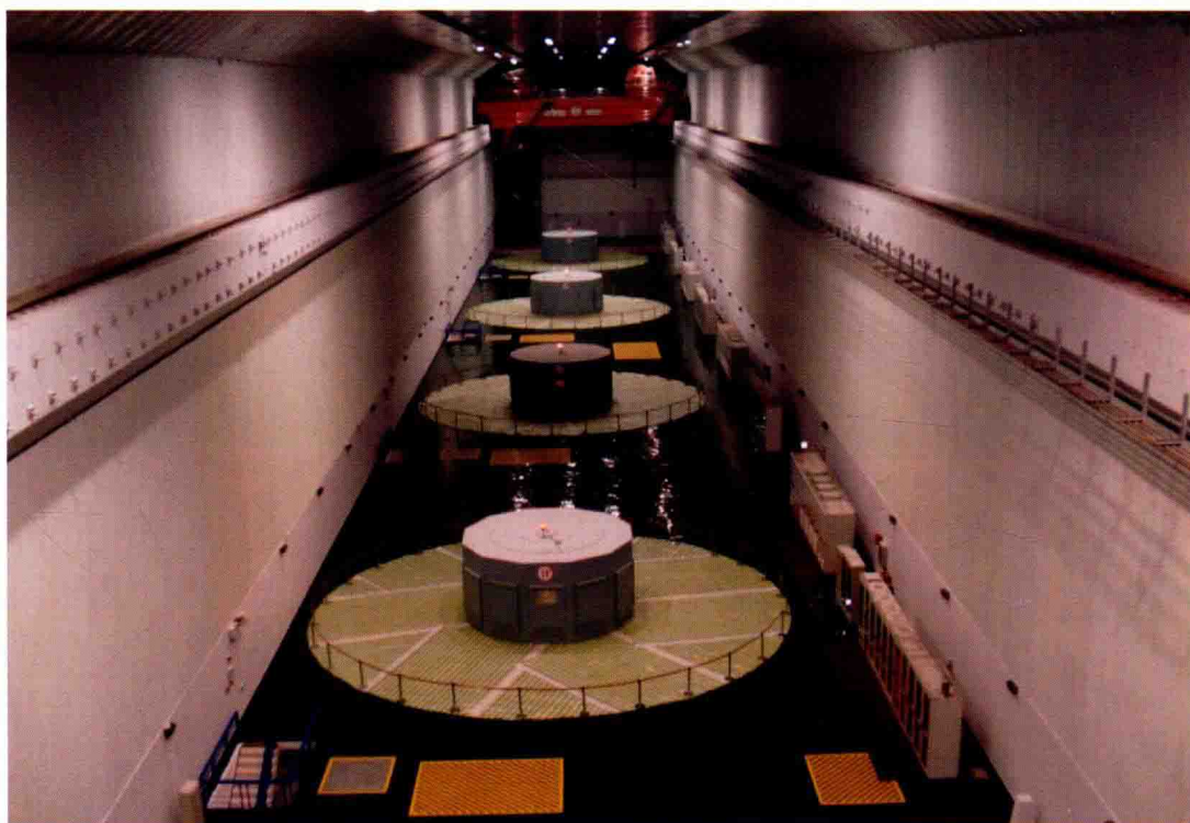
地下电站厂房
