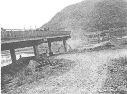
图 1.6 浙江某桥梁溶洞桩基塌陷
