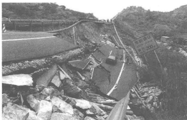
图 1.5 福建罗长高速公路路基坍塌
