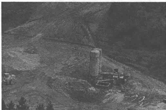
图 1-5 输电线路通道下违章施工实例
