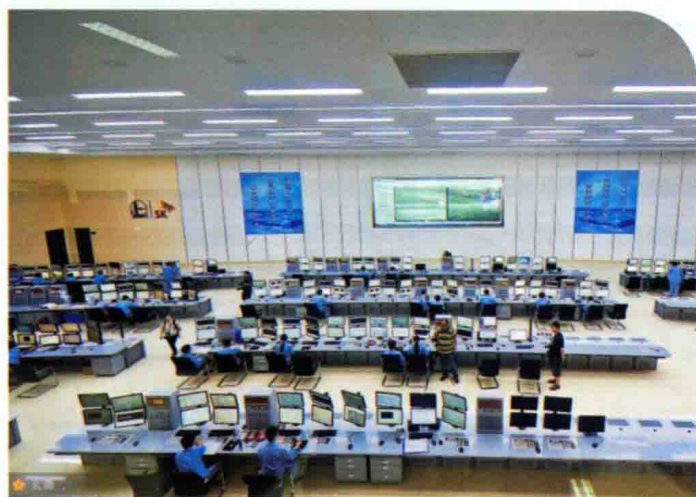
80万吨乙烯中央控制室
