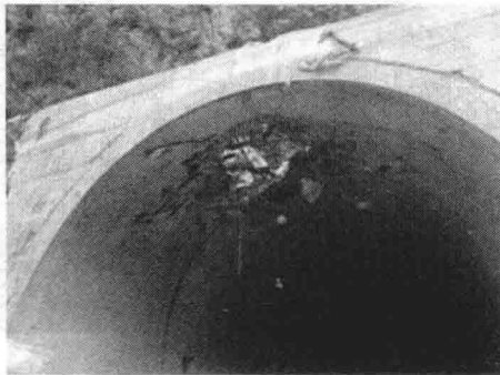
图 2-1 汶川地震中被落石击穿的隧道拱形明洞 [39]
