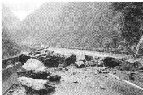
图 1-2 被巨石砸断的桥梁护栏
