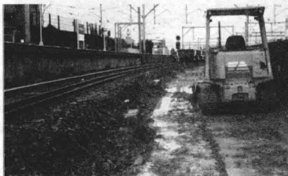
图 1-5 澳大利亚新南威尔士州排水不良的铁路线
