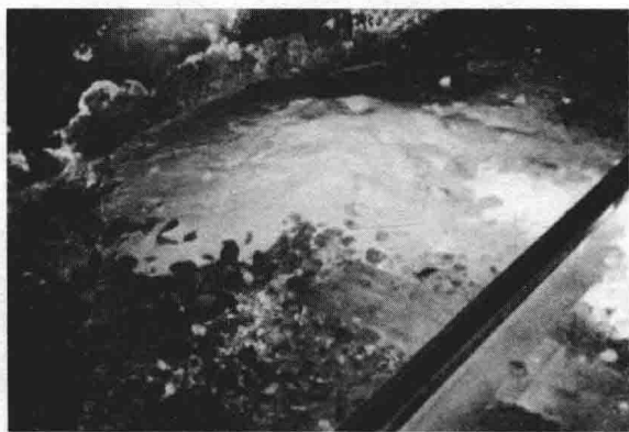
图 1-7 澳大利亚维多利亚州一条铁路线的翻浆冒泥情况
