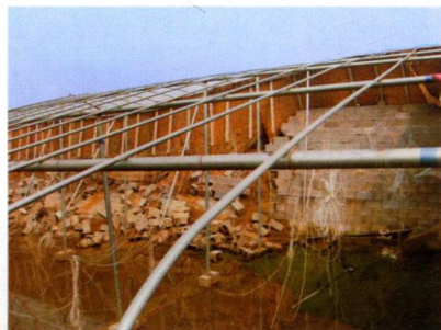
图2-13 雨后积水泡塌土墙
