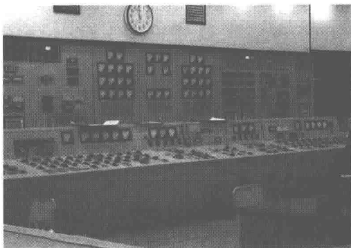
图 1-2 典型的电力系统中央控制室
