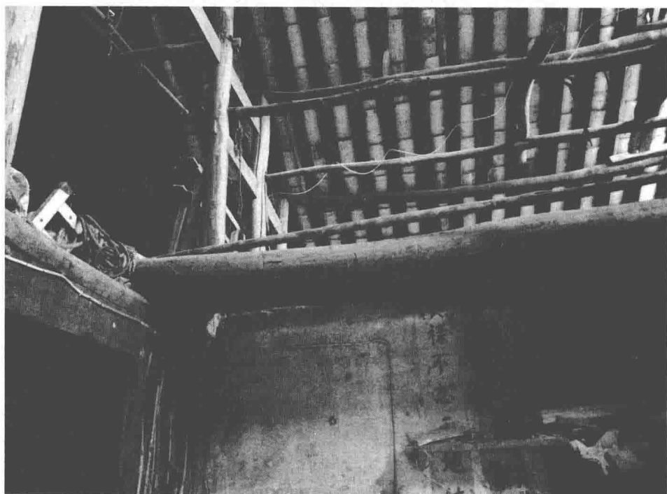
柱子搭接成的棚顶有些漏风
