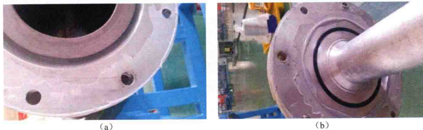
图 1-10 法兰对接面栓孔处有放电产生的痕迹
