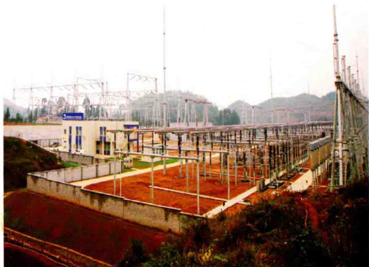
500千伏黄板输变电站
