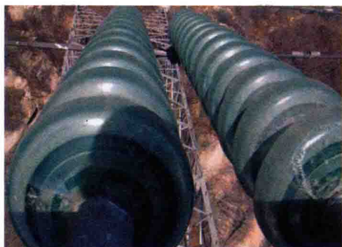
(a) 绝缘子顶端有放电烧蚀痕迹
