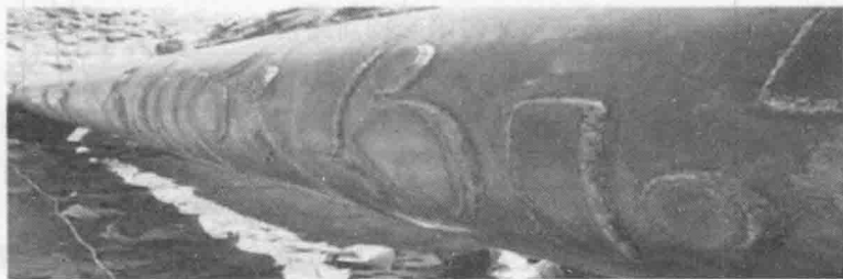
图 1-1-10 新旧管道腐蚀
