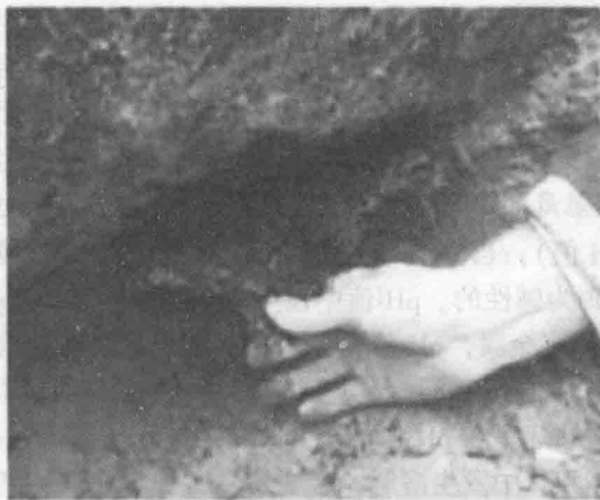
图 1-1-9 氢原子消耗引起的管道腐蚀
