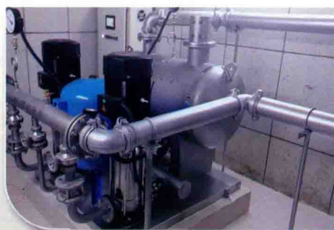
无负压变频供水设备
