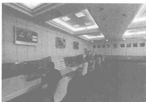
(b) 操作控制室概貌
