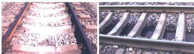
(a) 没有串空造成翻浆
