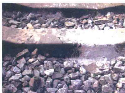
图 1-1-7 未掏空造成轨枕损坏
