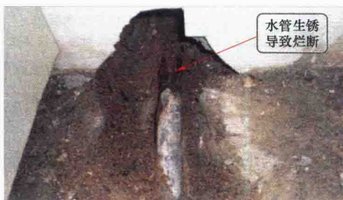
图 1-8 生锈引起漏水
