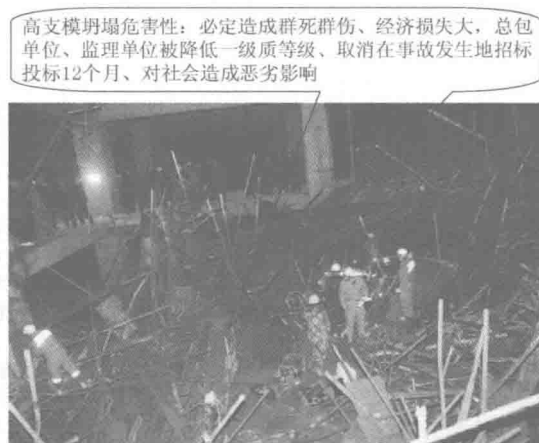
图 1.1-3 高支模坍塌实例
