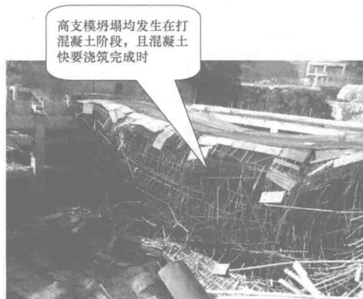
图 1.1-2 高支模坍塌实例
