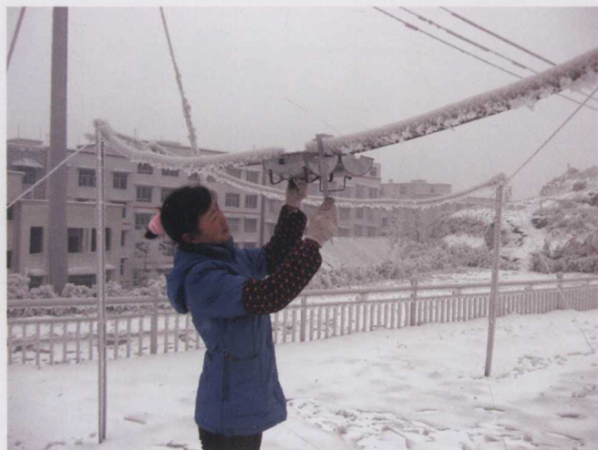
2008年冰冻灾害，贵州省电网设施受损严重。1月24日，万山特区气象局观测员在严寒天气下测得电线结冰厚度达163毫米
