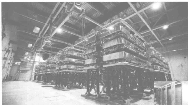
图2 厦门柔性直流输电示范工程换流阀厅
